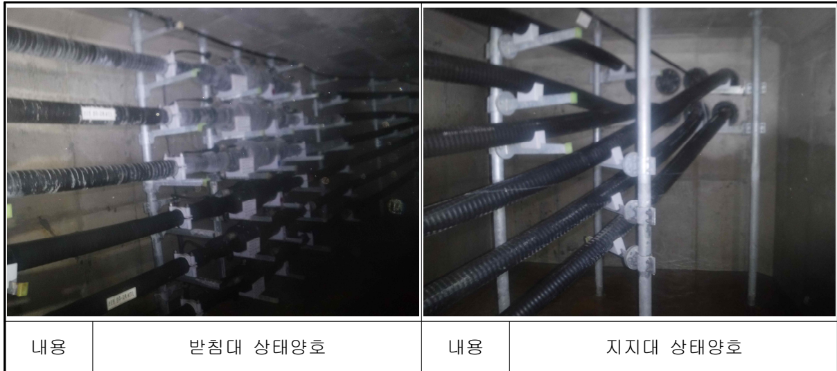
【사진 15.4】 부속 및 부대설비 현황
